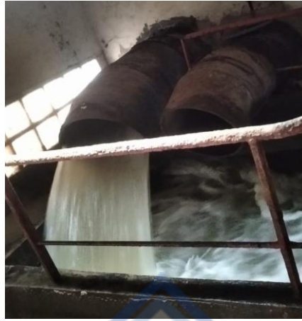
Gambar 3.3 bak intake (penampungan air baku)
