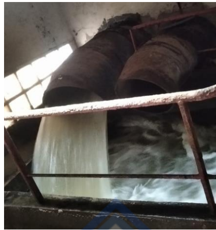
Gambar 3.3 bak intake (penampungan air baku)
